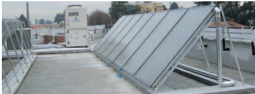
Pannelli solari termici
